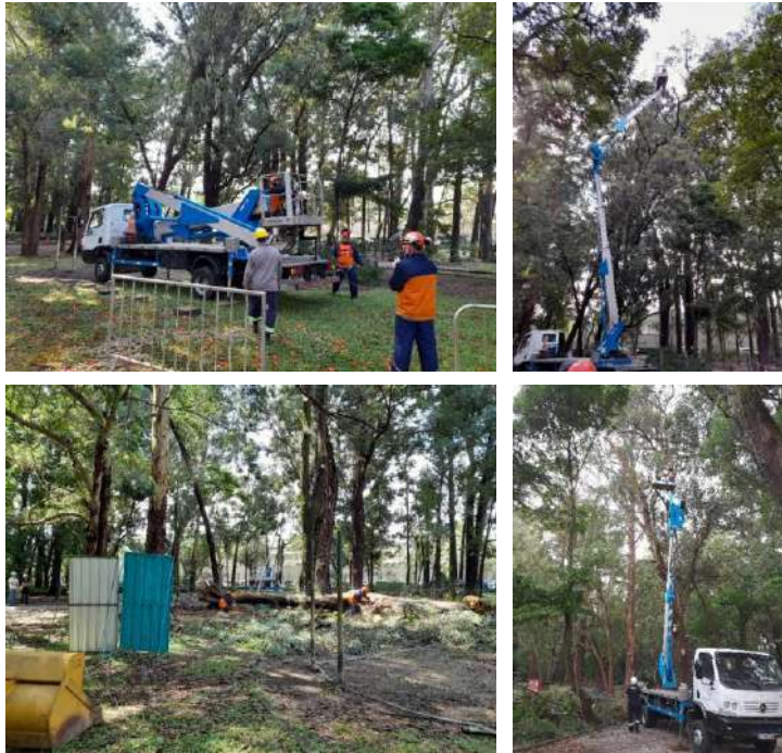
Figura 69: Supressão de árvore em risco de queda
